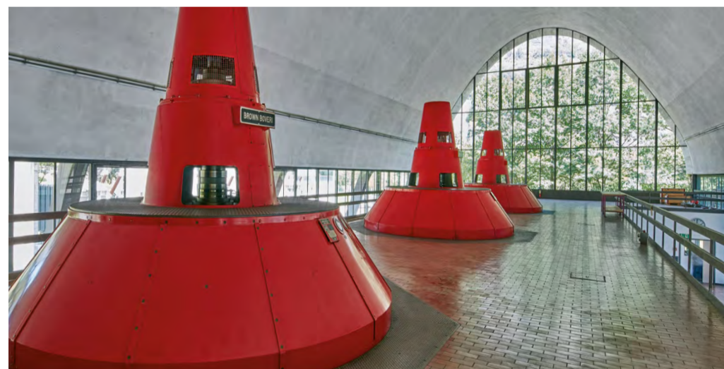
Interno della centrale Nuova Biaschina
