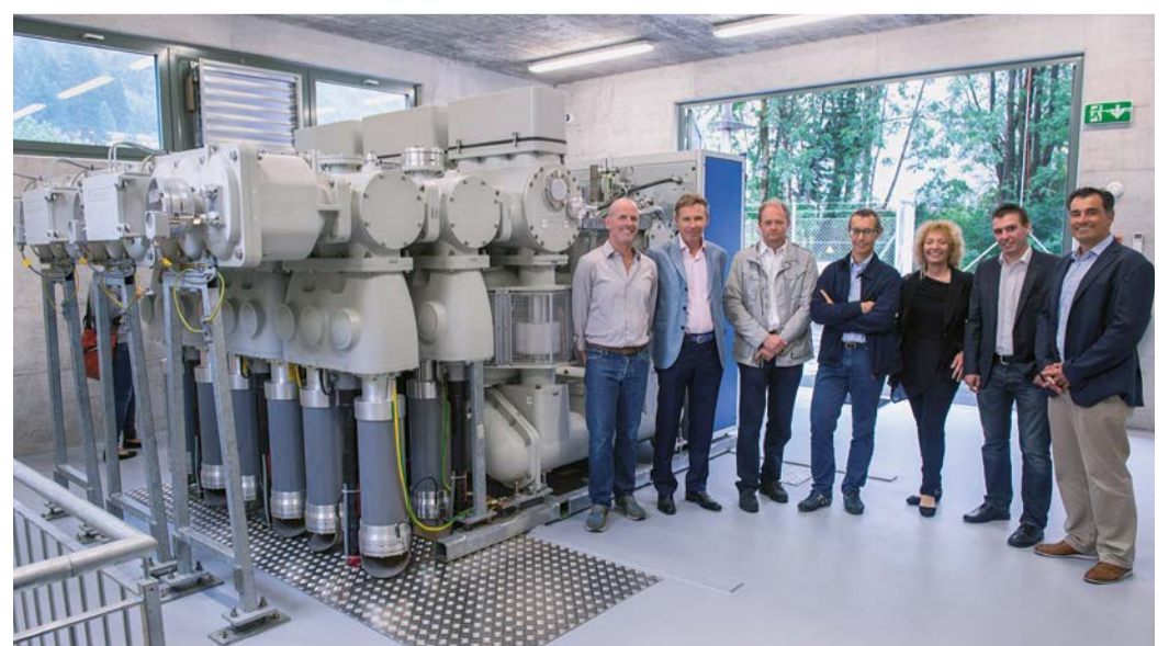
Le direzioni di AET e SES assieme ai Sindaci dei comuni della Valle di Blenio in occasione dell'inaugurazione della nuova linea 50 kV Acquarossa-Olivone.
