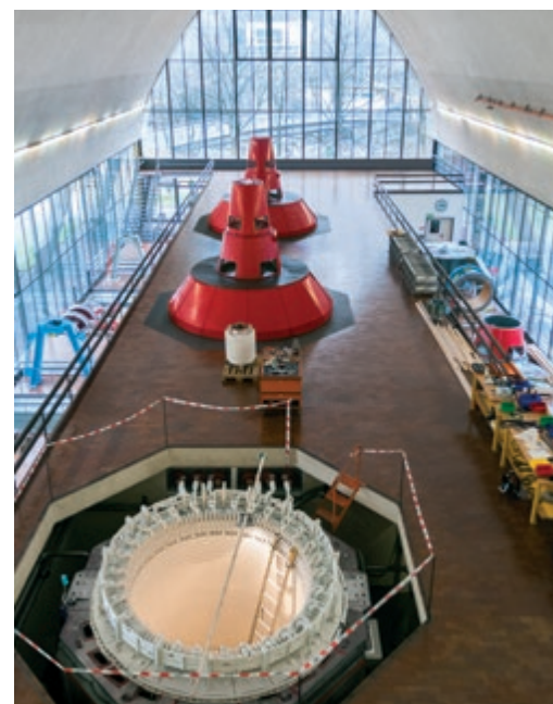
Lo statore del generatore del gruppo uno in fase di revisione nella centrale della Nuova Biaschina
