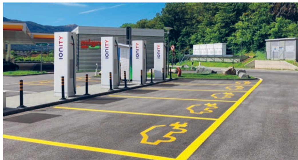
Le nuove colonnine High Performance Chargers di Ionity nell'area di servizio di Bellinzona Nord
