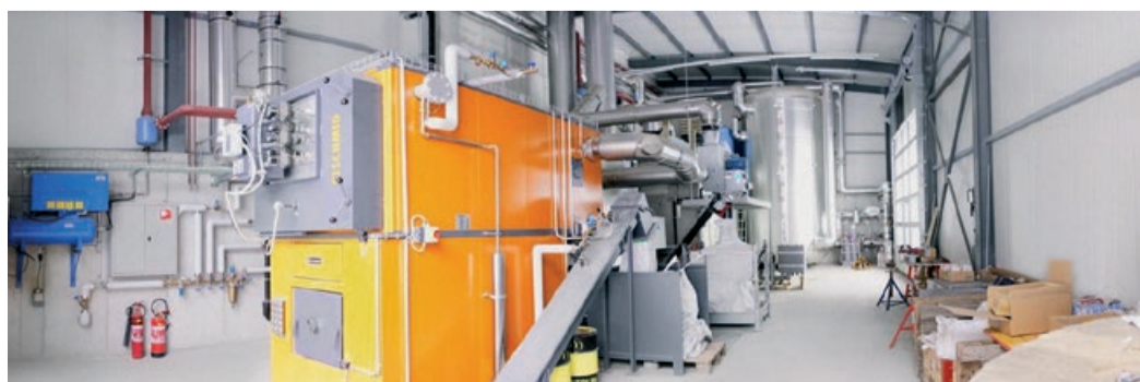
L'interno della nuova centrale a cippato di Olivone
