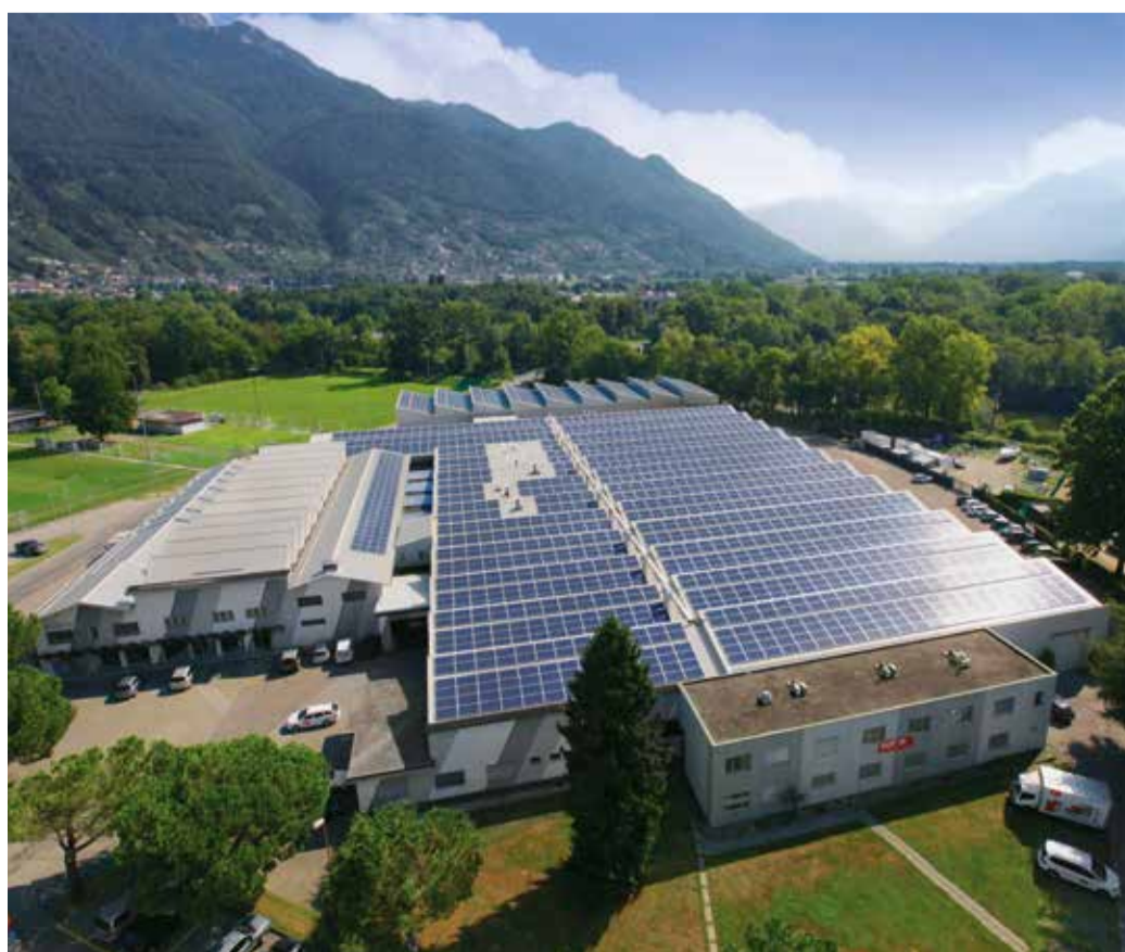
L'impianto fotovoltaico sul tetto di Sara SA a Tenero
